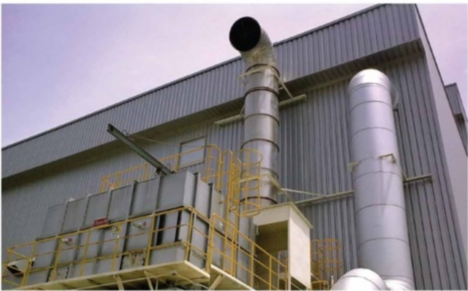
เครื่อง RTO: Regenerative Thermal Oxidizer ใช้เพื่อบำบัด VOC (Volatile Organic Compound)
